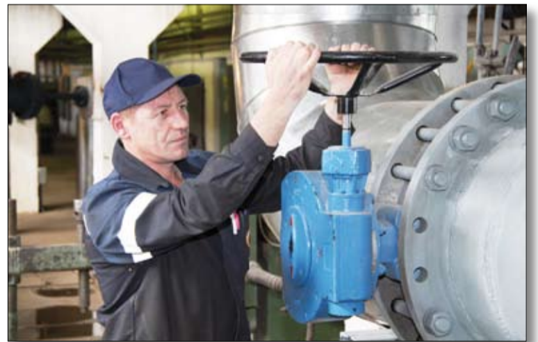
За исправной работой оборудования в центральной котельной следят все службы, в том числе и ремонтная группа во главе с бригадиром Валерием Бардиным.
